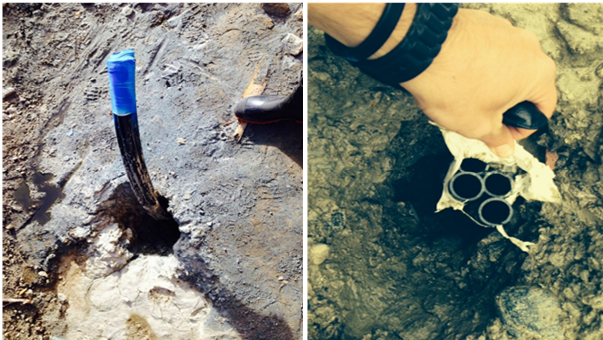
Abb. 10: Erdwärmesonden ohne Verpressschlauch und bei abgesackter Verpressung
